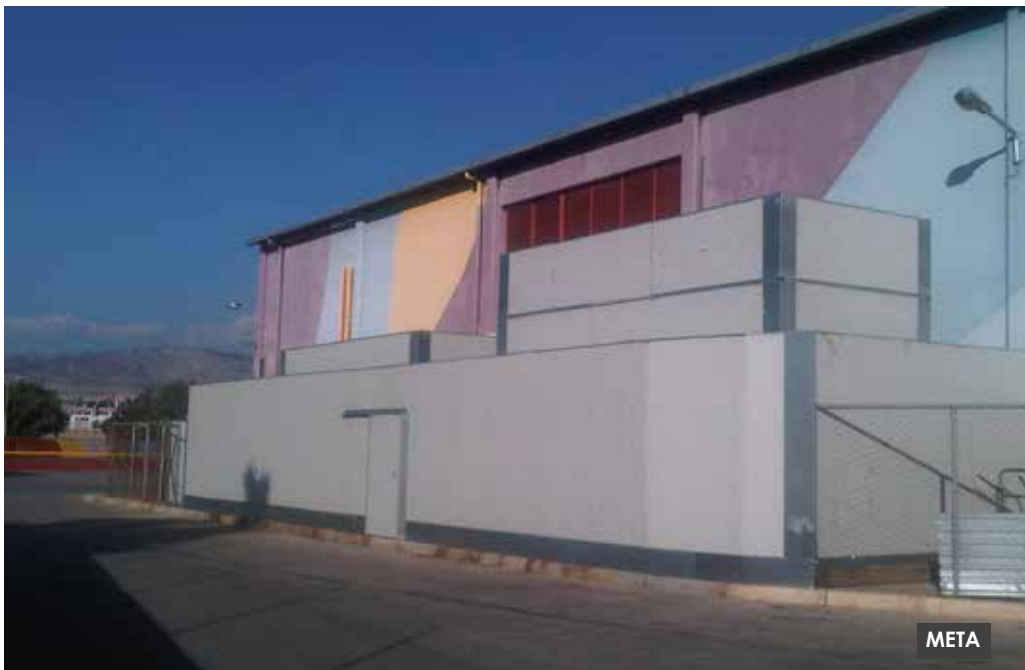
Ηχομόνωση ψυκτικού συγκροτήματος σε βιομηχανία τροφίμων
