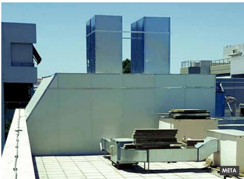
Ηχομόνωση κλιματιστικής εγκατάστασης Νοσοκομείου
