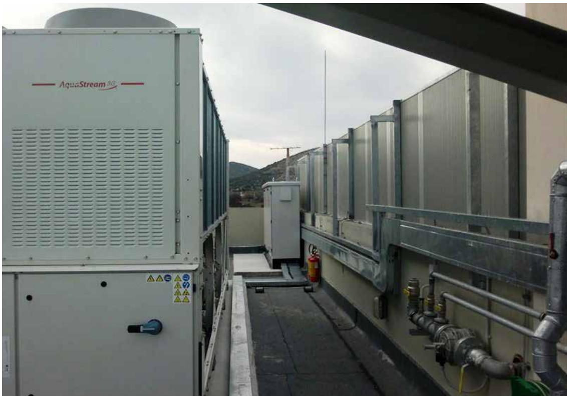
Ηχοπέτασμα σε ψύκτες κλιματισμού
