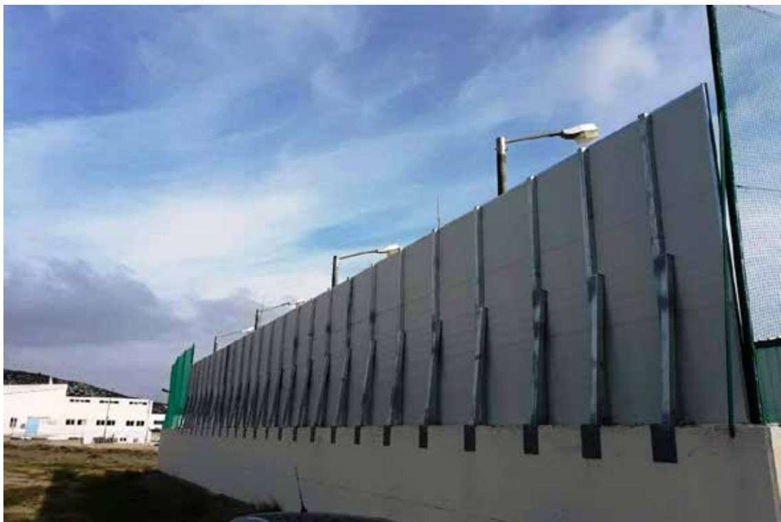
Ηχοπέτασμα Εγκατάστασης Φυσικού αερίου
