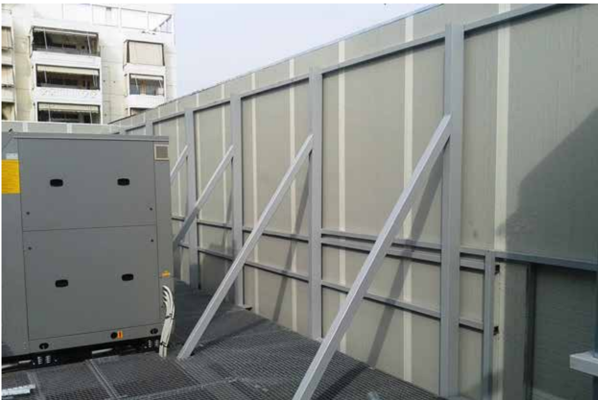
Ηχομόνωση ψυκτών κλιματισμού σε μεγάλο κέντρο δεδομένων
